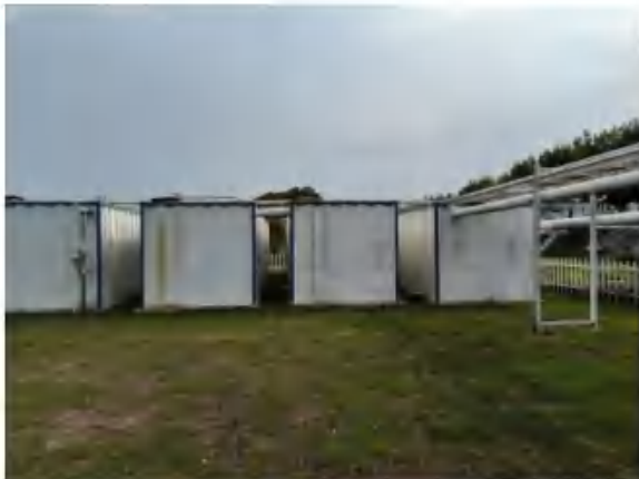
密闭污水处理设施
