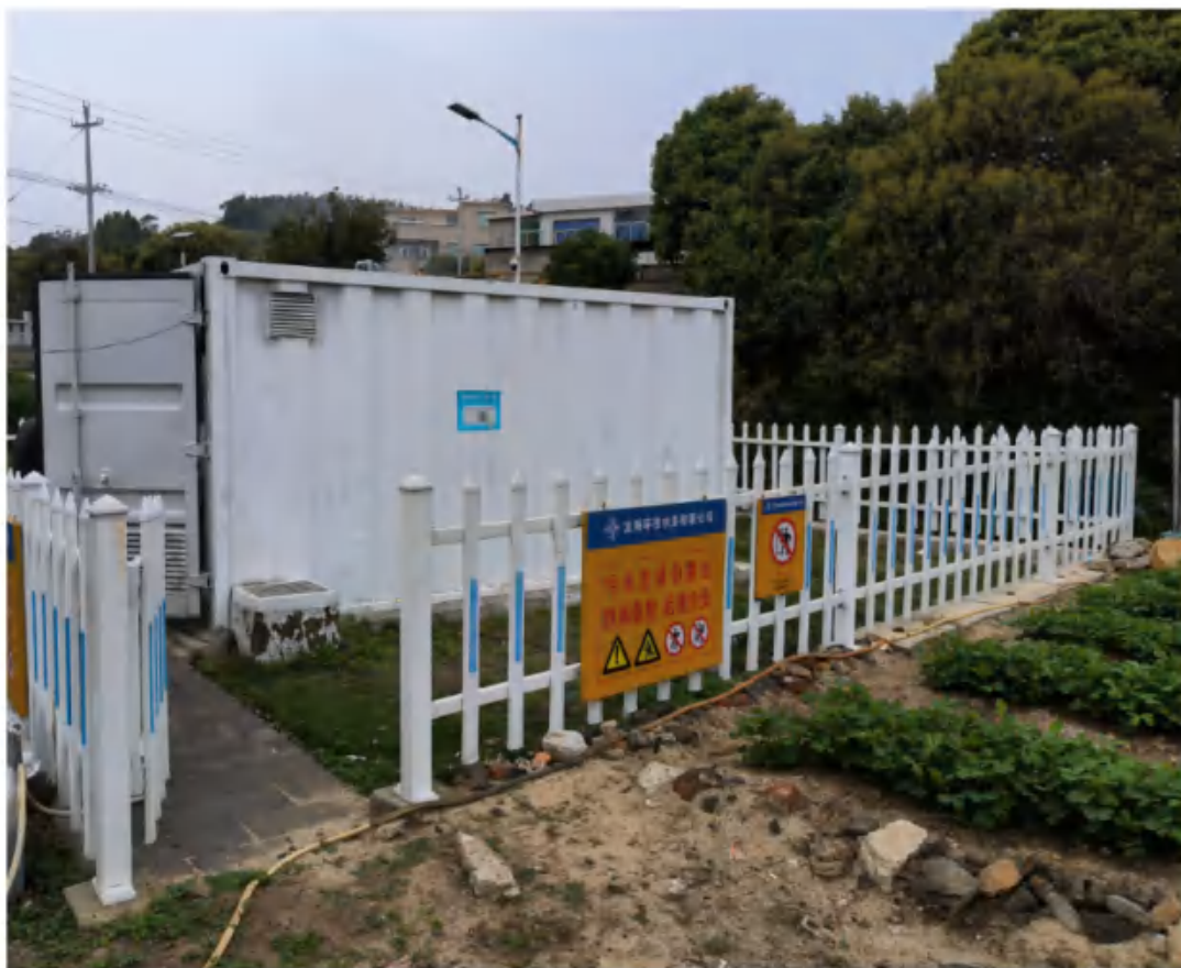
白坑B厂站全景
