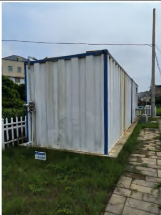
一体化污水处理设施
