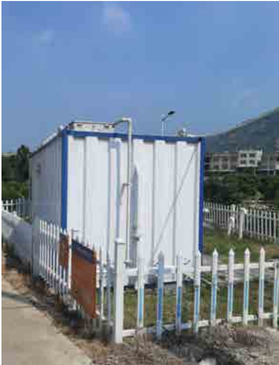
密闭污水处理设施
